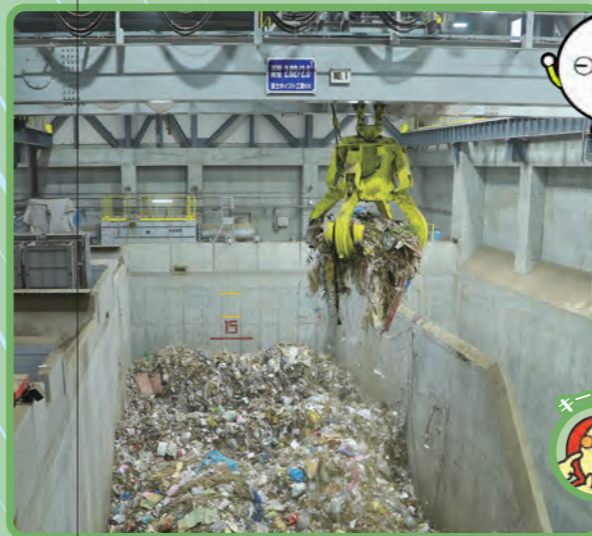
3 ごみピット・ごみクレーン ごみクレーンで焼却炉へ運びます。
