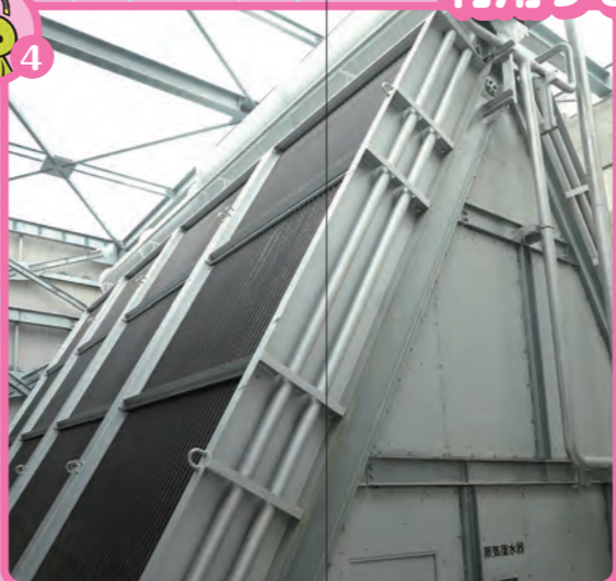
7 蒸気復水器 タービンで発電に利用した蒸気を水に戻します。戻した水はボイラに送られ、再び蒸気になります。
