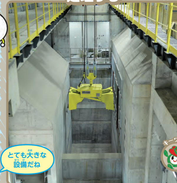
9 灰ピット 焼却灰を灰ピットにため、運び出します。
